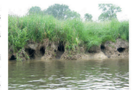
Dégâts sur berge
